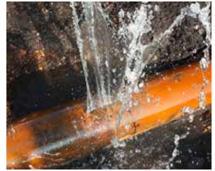
Antes de reparar
